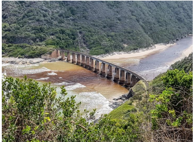
Leider ist der Viadukt des Outenqua Choo-Tjoe-Trains beschädigt
